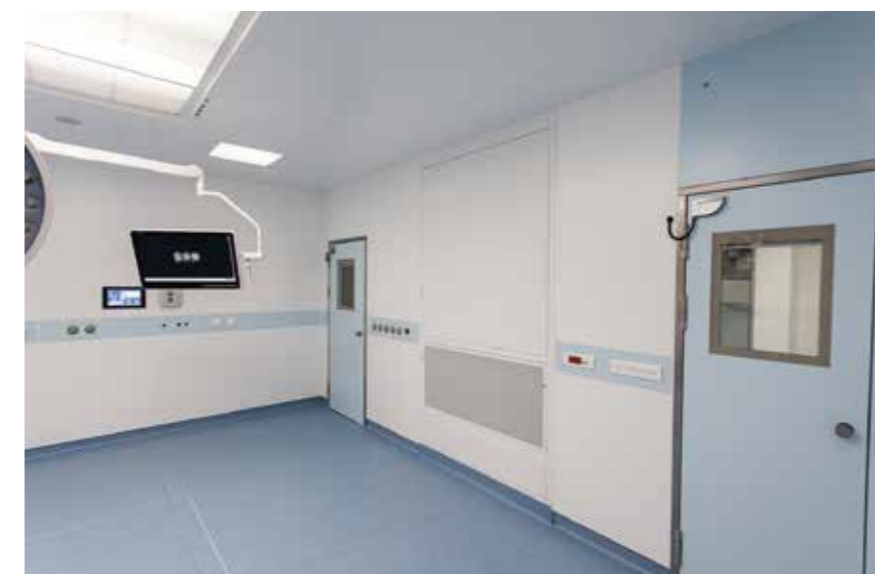
OP mit einem in der Zwischenwand eingebauten Umluft-Wandmodul/ operation theatre with wall-mounted recirculation module integrated in the false ceiling
